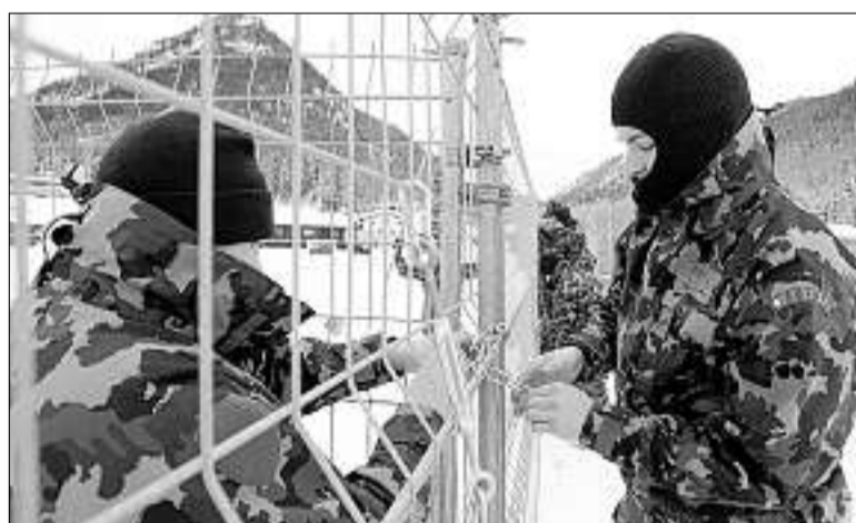
Bereits letzte Woche haben Soldaten begonnen, rund um den Helipad Stille Abschränkungsgerüste zu montieren. (Ky)
